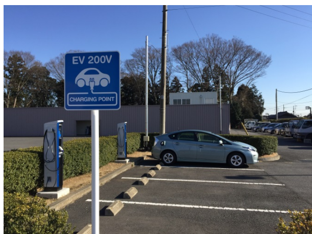
導入した次世代自動車充電設備 (EV・PHV用普通充電器)
